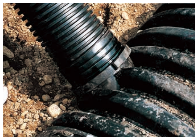
ゴム支管接続部
